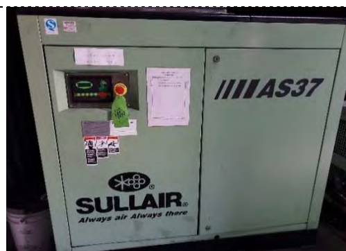
空壓機汰換後
