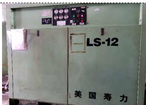
空壓機汰換前
