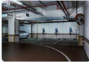
電動車充電站
